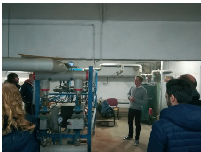
Węzeł cieplny w SP 21 w Płocku
