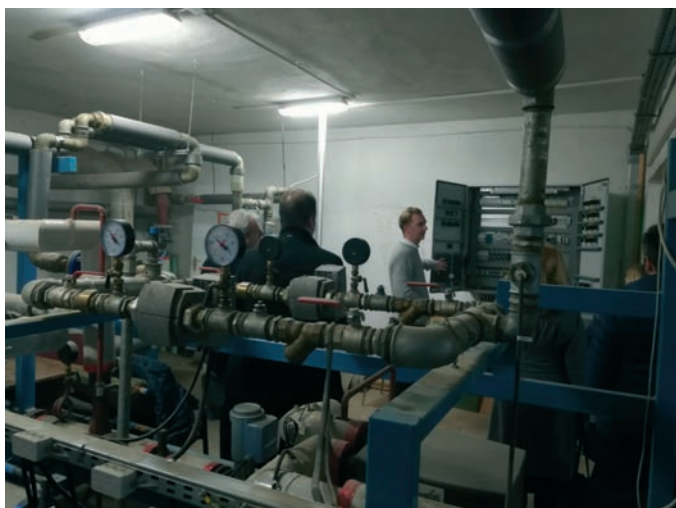
Węzeł cieplny w SP 21 w Płocku
