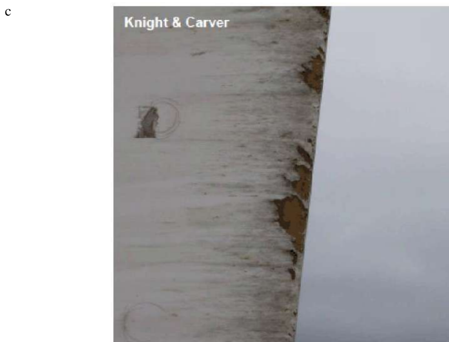
Rys. 1.34. Uszkodzenia łopat wirników wiatraków według 204 a) możliwe mechanizmy rozwoju uszkodzenia, b) odłamana część łopaty na farmie wiatrowej Korsze, c) postępujące uszkodzenia łopaty turbiny wiatrowej (Polska, 2012, materiały PSEW)
